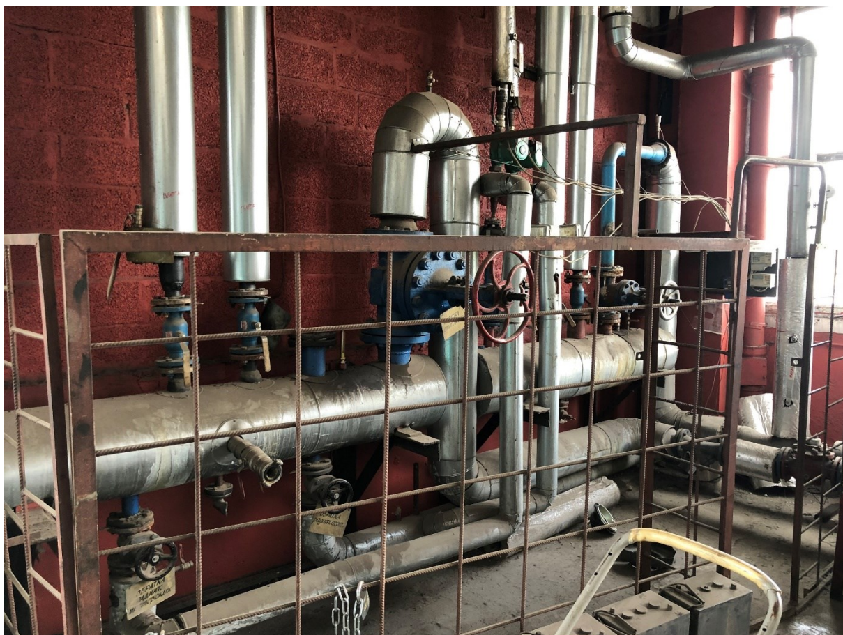
Peterburi tee 73 remonditöökoja hoone olemasolev soojussõlm
