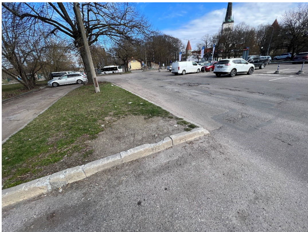
Pilt 5: korrastamata haljasala, vigastatud äärekivid ja amortiseerunud teekate.
