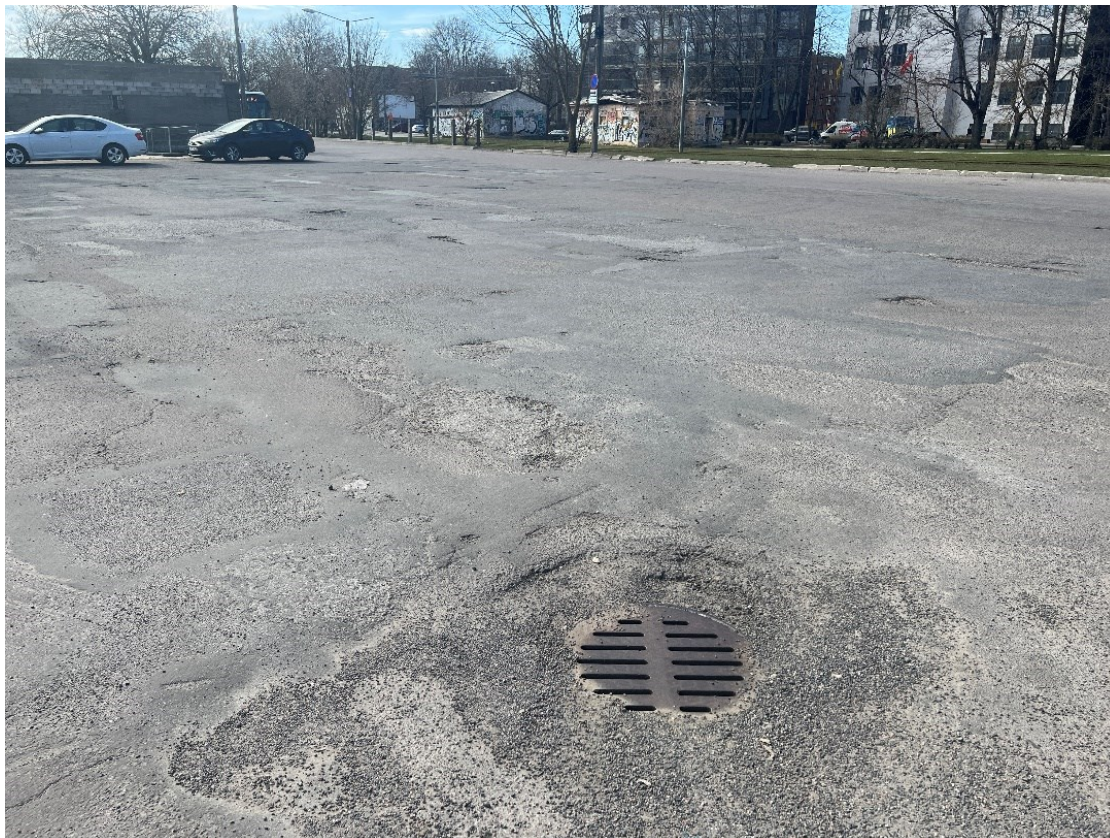
Pilt 9: olemasolev amortiseerunud teekate, kanalisatsiooni luugi ümbrus.
