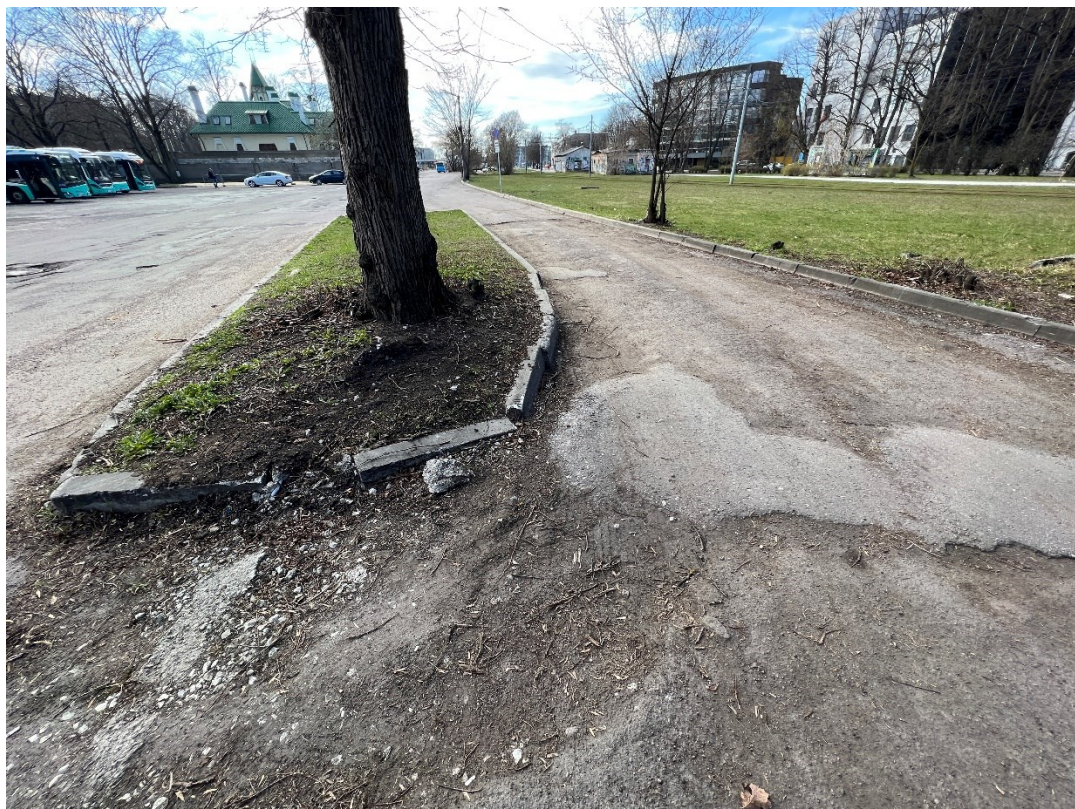
Pilt 6: korrastamata haljasala, vigastatud äärekivid ja amortiseerunud teekate.
