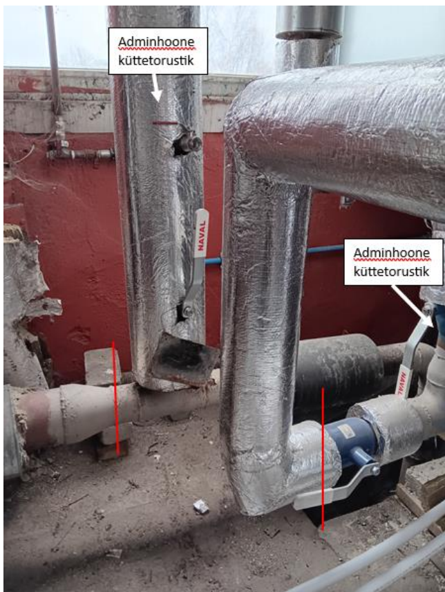
Foto nr 1: Kütetöid tuleb alustada hoone kaugkütetorustike sisenditest, pärast adminhoone kütetorustikke. Fotol on punase joonega märgitud tööpiir.
