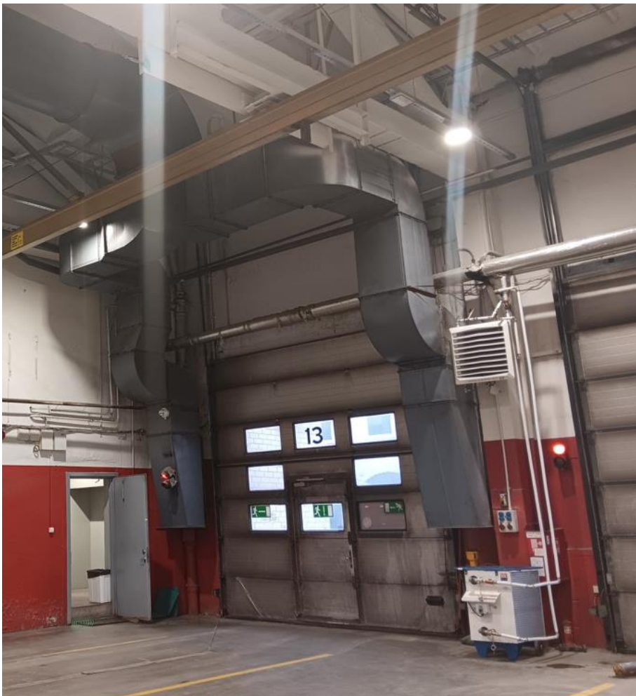
Foto nr 4: nähtub tõsteuks nr 13, millele tuleb kavandada uued õhkkardinad. Vanad tuleb utiliseerida.
