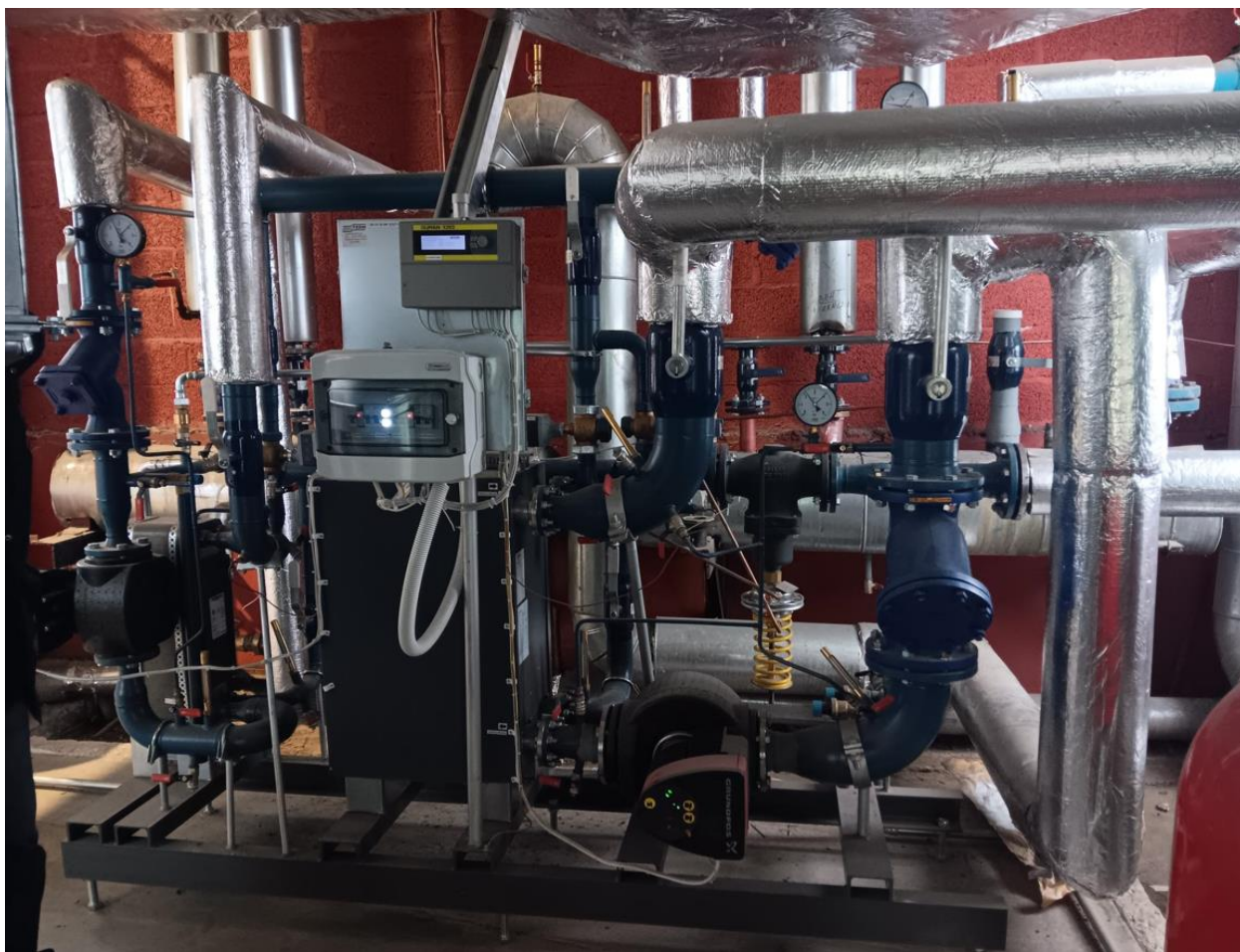
Foto nr 2: olemasolev soojussõlm, mis tuleb välja vahetada.
